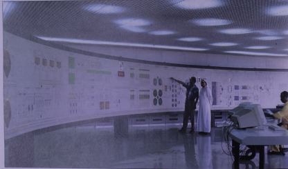
غرفة التحكم الرئيسية في محطة معالجة مياه الصرف الصحي
