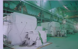
تضم محطة الطاقة الكهربائية في ألبا، ٢٤ توربينات تعمل بالغاز الطبيعي وذلك بمتسعة ٤٨٠ ميجاوات . في حين تستغل الحرارة المتبذدة الصادرة عن خمس من هذه التوربينات لتشغيل توربين بخاري بولد ٦٠ ميجاوات
