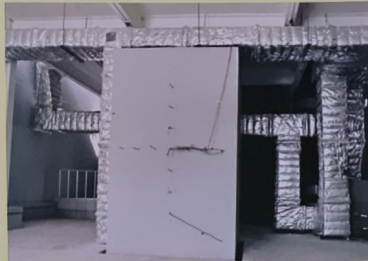
نظام التخزين الحراري وشبكة انابيب الهواء
