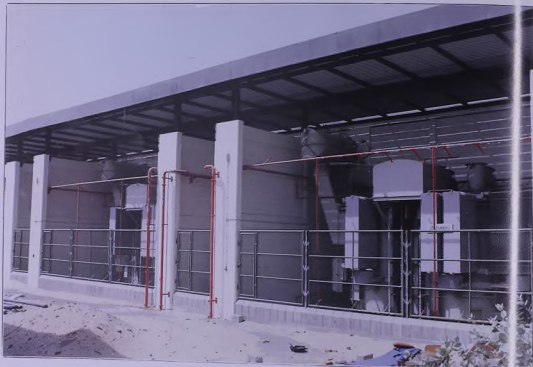
إحدى محطات التوزيع الفرعية ١٣٢ كيلو فولت في مدينة الشارقة A 132 KV Substation in Sharjah City
