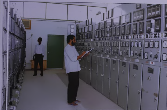
منظر داخلي لإحدى محطات التوزيع الفرعية ٦,٦ / ٣٣ كيلو فولت Inside view of a 33/11 substation
