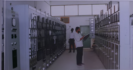
غرفة التحكم في محطة الناصرية Control Room at Nassiriyah Station
