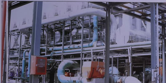
وحدة التحلية رقم (٧) في محطة كهرباء اللية Desal Unit No. (7) Layyah Station
