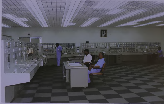
وحدة التحكم في وحدات المرحلة الأولى والتوربينات الغازية بمحطة توليد اللبية Labyrinth Station - Phase I units & Gas Turbine Control Desk
