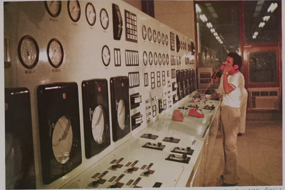
غرفة التحكم والمراقبة في محطة سفرة
