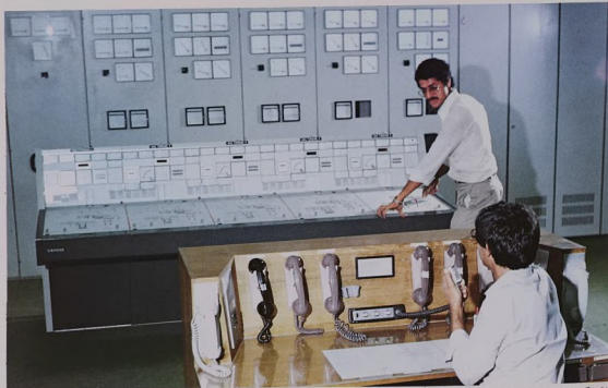
غرفة التحكم والمراقبة في محطة الرفاع
