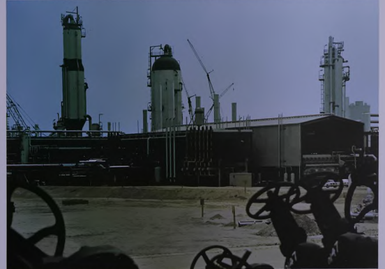
وحدة إنتاج الهيدروجين ووحدة تعطير الخام تحت الضغط المنخفض ، كاس هيدروجين (في الخلفية) ، أبراج التقطير تحت الضغط الجوي والضغط المنخفض (في الأمامية) .
