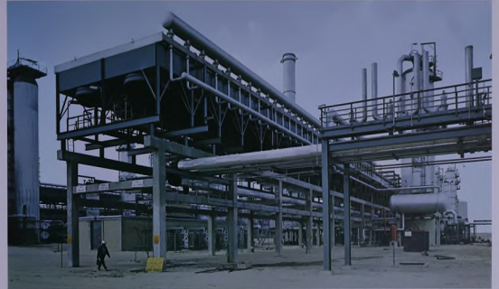
٥٠ مليون قدم مكعب في اليوم تقريبا : وحدة غاز البرفان ، ٥٠ / ٤٩ برميل / اليوم : وحدة تجزئة الباندا ، ٥٠ مليون قدم مكعب في اليوم : وحدة الامين
