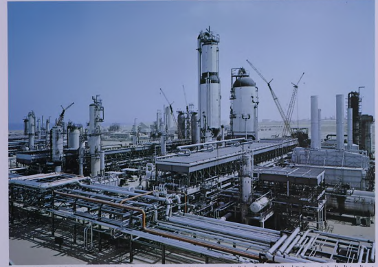
(من اليسار الى اليمين): وحدة نظير الخام تحت الضغط المنخفض ، وحدة (H-Oil) ، وحدة الاملاح العامل المساعد ، وحدة معالجة النافثا بالهيدروجين .
