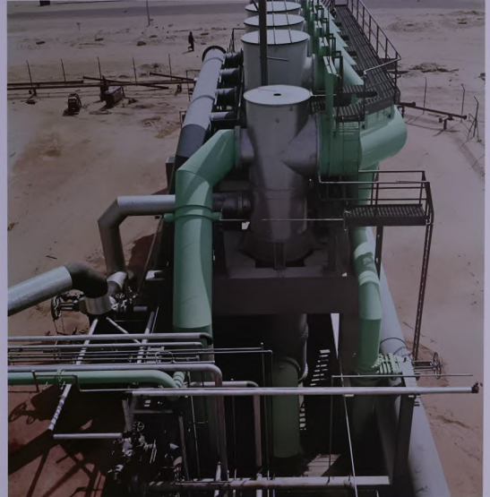
مجموعة المبدلات الحرارية التي تستخدم ماء البحر .
