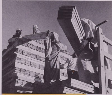
سيارة نقل نابعة لاحد الفاولين تُحمّل بالاخشاب من ساحة عملة المواد البناء .
