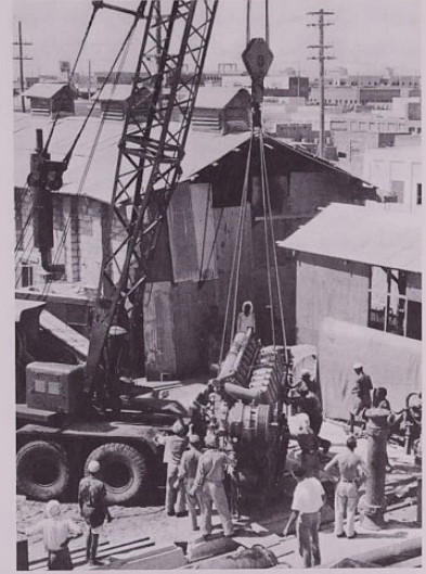
في سبيل تلبية الطلب المتزايد على القوة الكهربائية يزيد معمل كهرباء الخبر طاقتيه بتركيب مولد إضافي وزنه ١٤ طناً.
