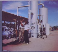
في مركز لتجميع النفط
