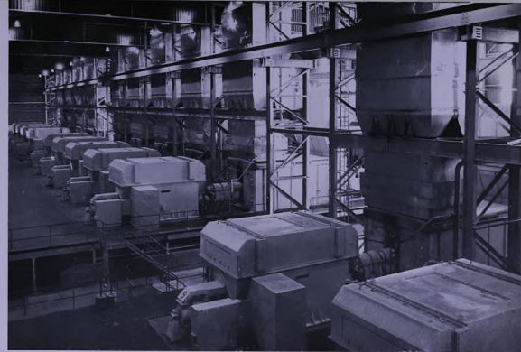
جانب من قاعة التريشيات ، وتبدو في الصورة إحدى عشر وحدة من مجموع ١٨ وحدة - وتعتبر محطة الكهرباء، عمدة أكبر محطة لتسغيل الغاز في العالم ، وعندما يستكمل بلتازعا ستبلغ طاقتها ٣٠٠ ميغاطن تاريسيا *
