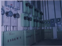
عدادات برمكة داخل مسجده الإسكان Meter installations inside a multi-unit building
