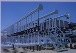
شبكة انابيب دخول النفط الخام في مركز التجميع ٢١ Crude oil incoming manifold at Gathering Centre No. 21.
