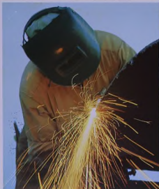
يقطع الفولاذ لانشاءات صهاريج التخزين الحديدية Cutting steel for the new tankage.
