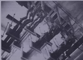
القضبان النحاسية لتغذية التيار الكهربائي الممتدة إلى الخلايا الإلكتروليتية Copper bus bars to the Electrolytic Cells, Chlorine Plant.
