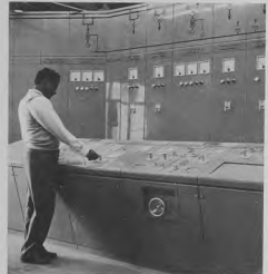
محطة كهرباء «ج» في الكويت طاولة المراقبة
