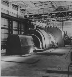
محطة كهرباء «ج» في الكويت مظهر عام لوله توربيني
