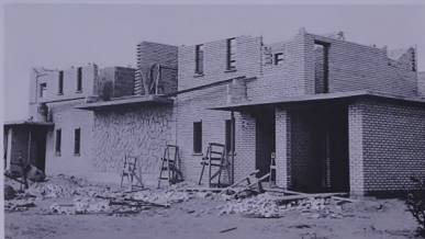
بيت للعمال قيد البناء في الاحمدي ، وهو ذو طابقين ، ومن طراز جديد ( م.ك. ١٥ )
