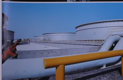
تم إنشاء خزائين السعة الاسمية لكل منهما 1,25 مليون برميل وخران واحد سعته الاسمية مليون برميل في فريسة رأس تنورة البحرية.
