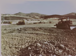
العمل يجري بشكل دائم ومنظم وبمعدلات مرتفعة للانتهاء من تنفيذ مشروع كهرباء الباحة المركزي .
