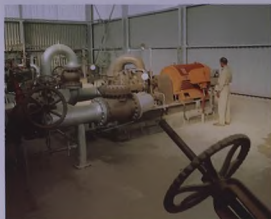
داخل محطة الضخ في مركز التجميع رقم ١٩
